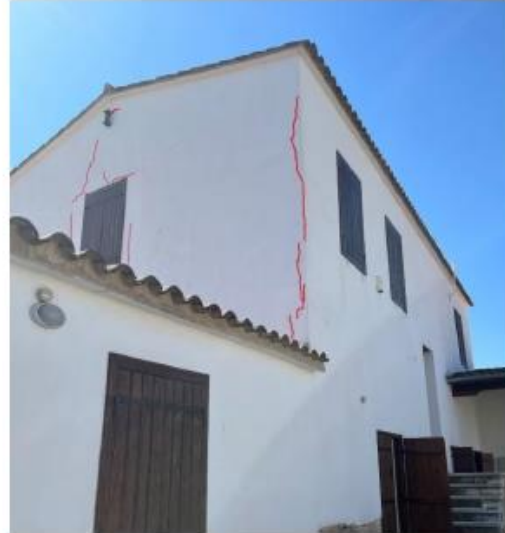
Φ.10: Έντονες κατακόρυφες ρωγμές στη εξωτερική γωνιά της τοιχοποιίας του ορόφου και τριχοειδής ρωγμές επιχρίσματος γύρω από το άνοιγμα. Παράλληλα, στη συγκεκριμένη βόρεια όψη του ορόφου, παρατηρείται συμπλήρωση ρωγμών από προηγούμενη φάση επεμβάσεων κάτι που υποδηλώνει πως ο όροφος επιδιορθώθηκε και δεν ανακατασκευάστηκε όπως αναγράφεται στα στατικά σχέδια.
