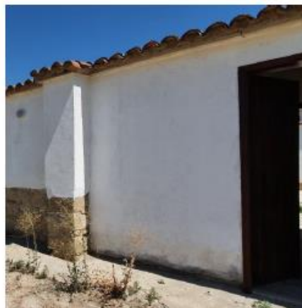
Φ.6: Μερική παρουσία ανιούσας υγρασίας στη βάση των θεμελίων όπου το επίχρισμα φαίνεται να καλύπτει μεγαλύτερο μέρος της λιθοδομής μέχρι κάτω χαμηλά, σε αντίθεση με την υπόλοιπη πίσω όψη.
