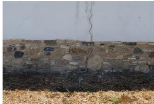
Φ.9: Έντονες κατακόρυφες ρωγμές τοιχοποιίας που φτάνουν μέχρι τα θεμέλια και διασχίζουν τη λιθοδομή ακολουθώντας τον αρμό των λιθοσωμάτων. Υπάρχει η υποψία ότι πρόκειται για επιφανειακή θεμελίωση.
