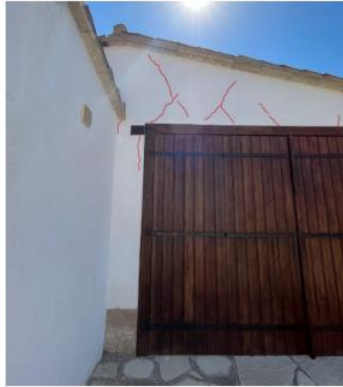
Φ.9: Τριχοειδής διαγώνιες ρωγμές επιχρίσματος άνωθεν του ανωφλιού της θύρας.
