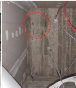
Φ.5: Εντοπίζονται εκτεθειμένοι οπλισμοί σε μεμονωμένα σημεία στην πλάκα άνωθεν ισόγειου
