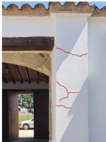
Φ.8: Τριχοειδής ρωγμές στην αντηρίδα της καμάρας και σημειακή απουσία συνδετικού κονιάματος μεταξύ των φυσικών λίθων της καμάρας.
