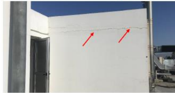
Φ.3: Προβλήματα αποκόλλησης τοιχοποιίας από φέρον οργανισμό (οροφή – απόληξη κλιμακοστασίου)
