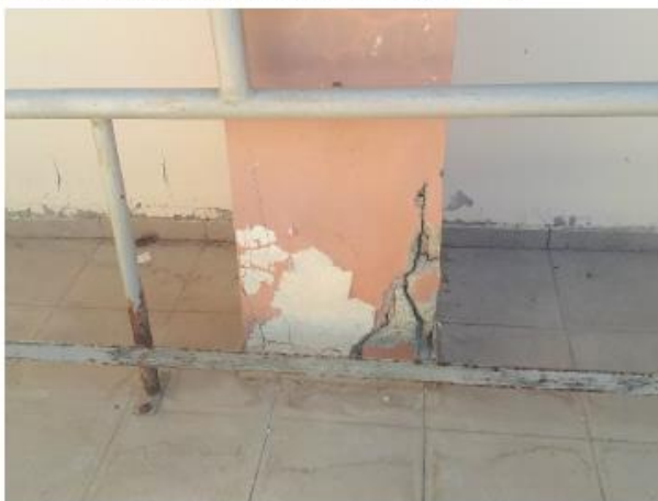
Φ.6: Αποσάθρωση και εκτεταμένου εύρους ρηγμάτωση σε υποστυλώμα (Νότια όψη κύριας κατασκευής)
